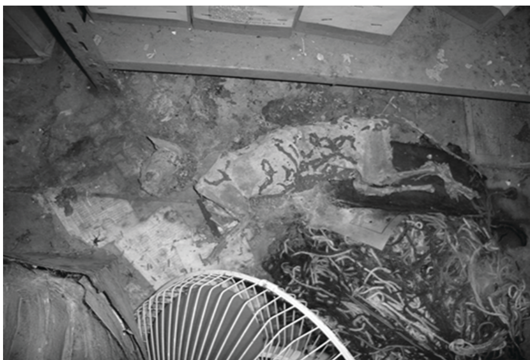
FIGURA N°. 11. Animal muerto, localizado en descomposición en el depósito.
