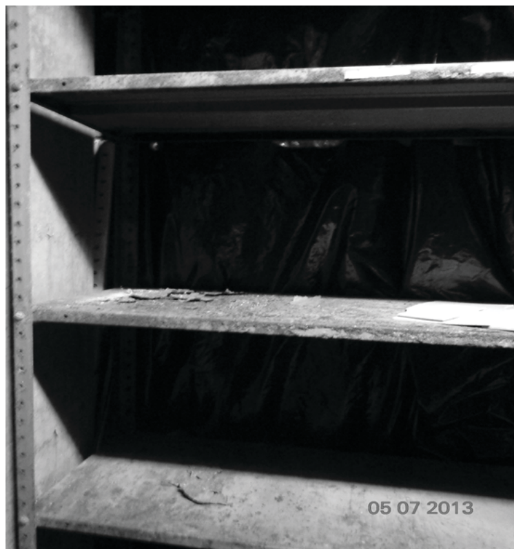
FIGURAS N°. 32 y 33. Daños causados por humedad excesiva a las estanterías y al papel.
