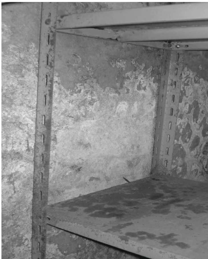
FIGURAS N°. 12. Estado de las estanterías, completamente oxidada.
