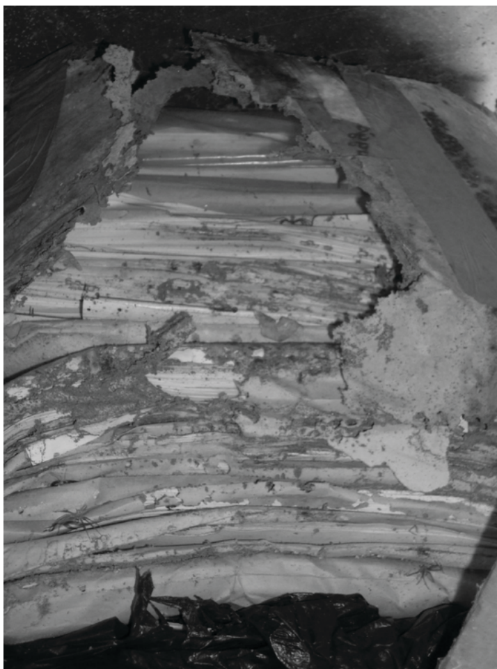
FIGURAS N°. 51 y 52. El estado del papel, deterioro por humedad.
